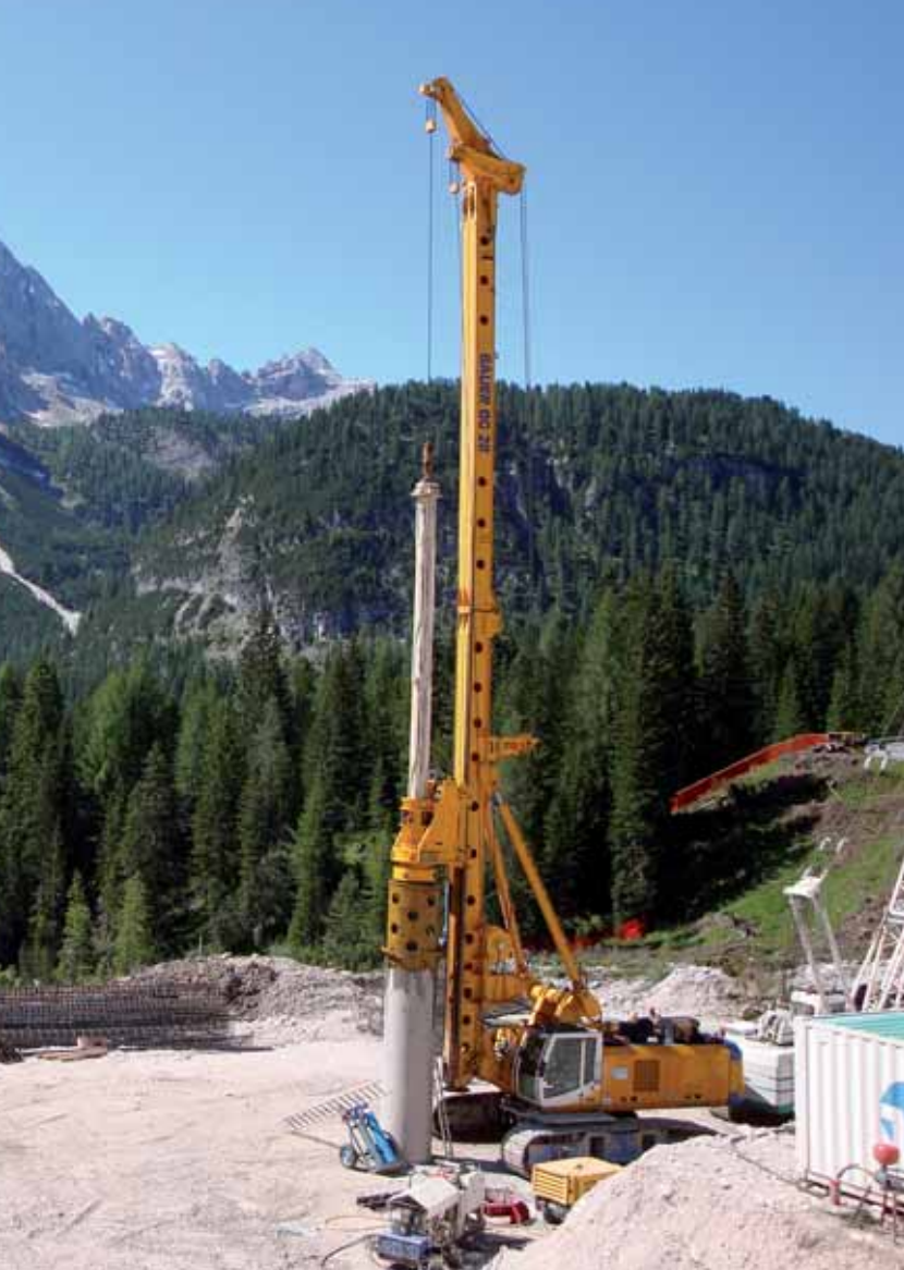
▲ Für die Gründung einer Talbrücke bei Cortina in den Dolomiten ▲ setzt ein Kunde auf ein Drehbohrgerät BG 28.
