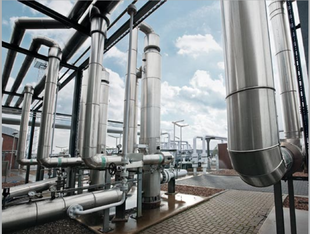
Pipelines des Gasspeichers Huntorf, Elsfleth
