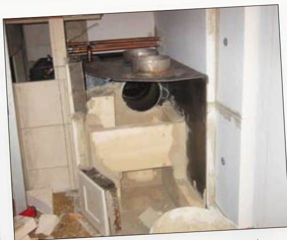
2007: Kaum noch Energiekosten dank der neuen Fassade und dem neuen Ofen.
