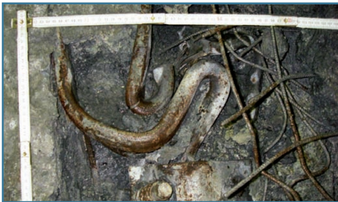
Deformation eines Ausbauelements durch Gebirgsdruck Foto: AlpTransit Gotthard AG
