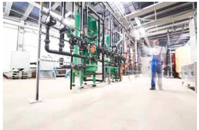
Umweltschutz durch gezielte Abwasserbehandlung
