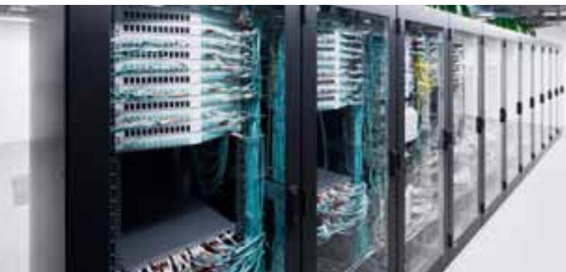
Rechenzentrum der Aareon AG, Mainz
