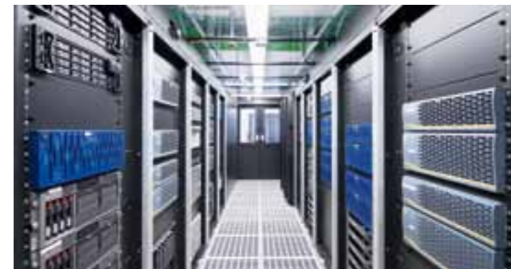
Rechenzentrum der Aareon AG, Mainz
