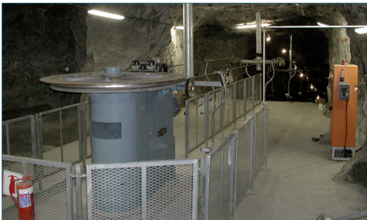
Antriebsstation eines Sessellifts
