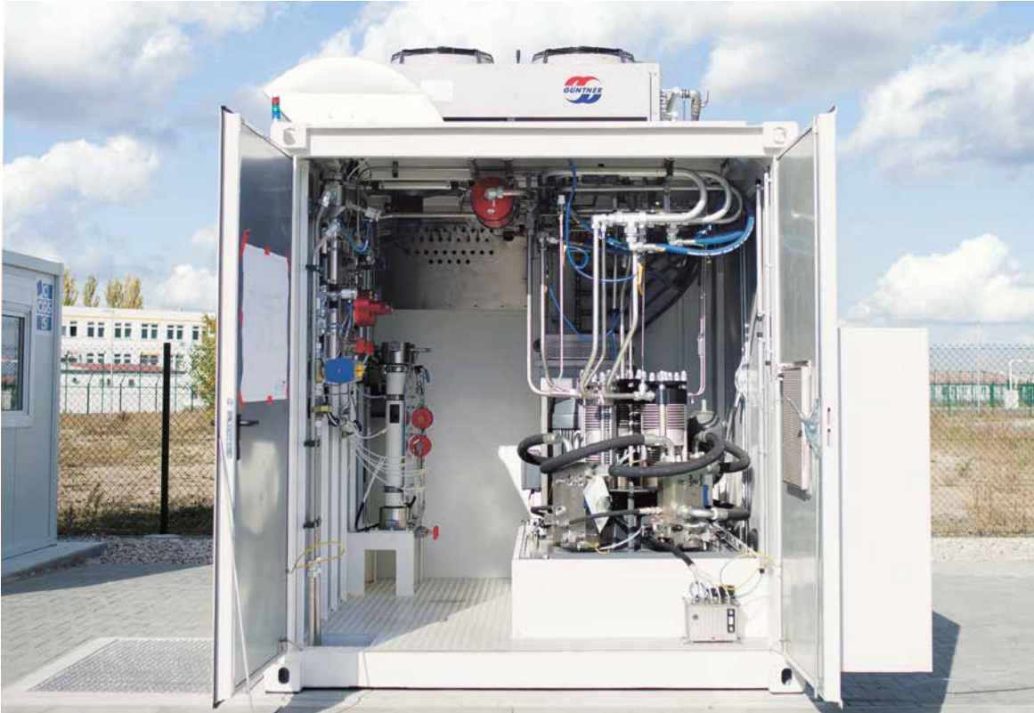
Blick in eine fertig montierte Wasserstoff-Kompressorstation.
