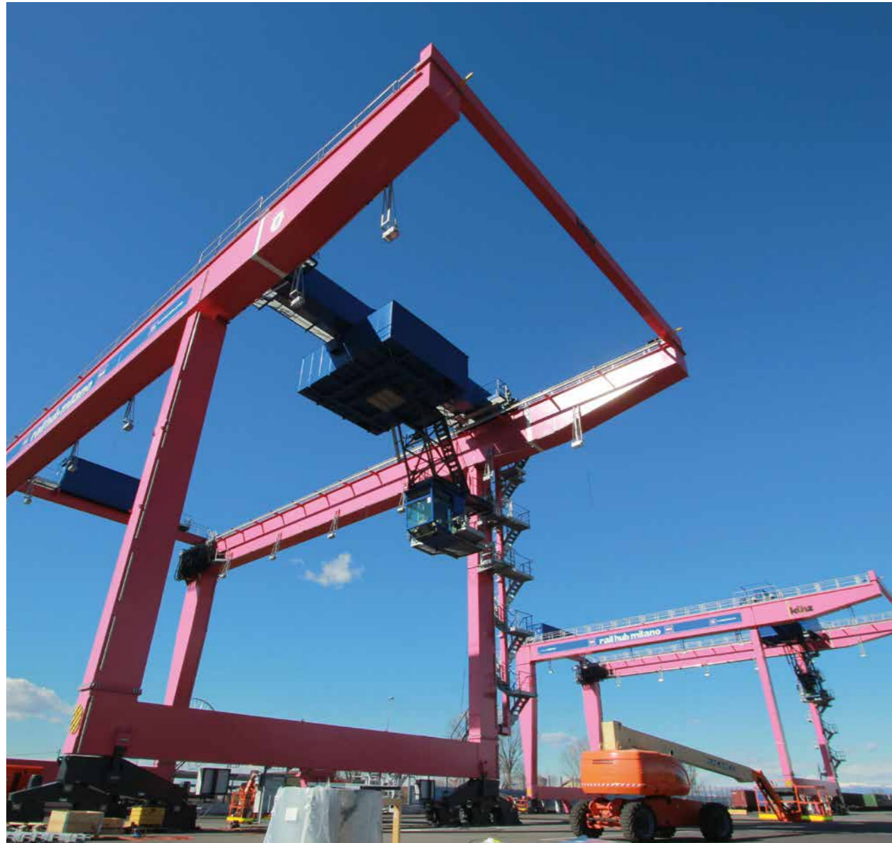
Aufbau der neuen RMGs (Railway Mounted Gantries) am Rail Hub Milano in Melzo, Norditalien.
