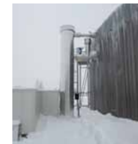
Bei extremer Kälte werden oft Frostwächter oder Heizaggregate eingesetzt.
