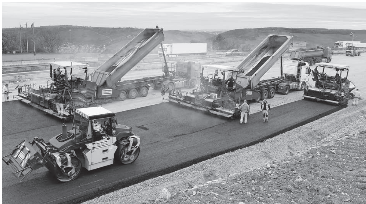
BAB 3 Heidingsfeld–Randersacker, Asphaltteinbau
