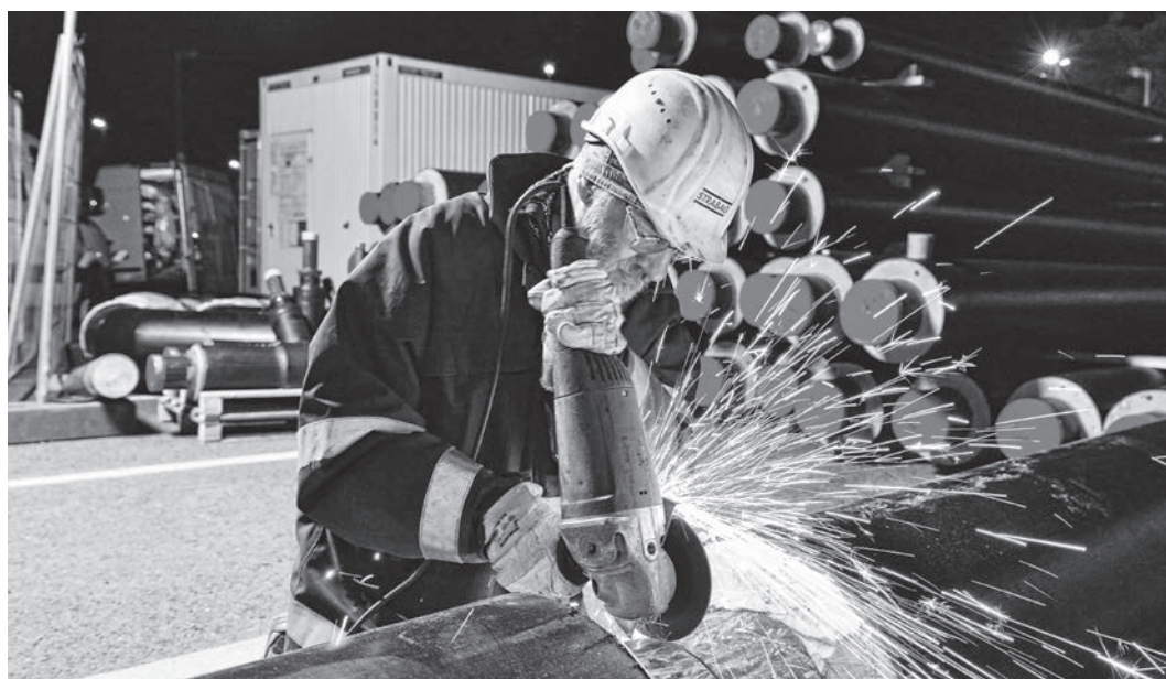
Autostadt Wolfsburg, Fernwärme
