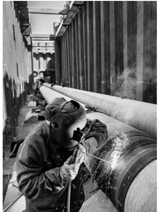
Flughafen Frankfurt/M, Kerosinleitung
