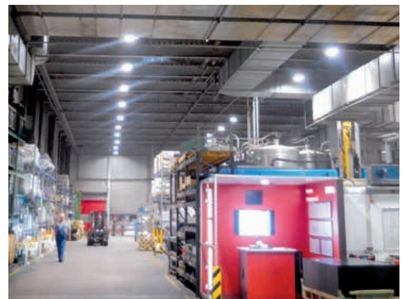
Ein nachhaltiges Beleuchtungskonzept, das auch noch 60 Prozent Energie gegenüber dem bisherigen spart: In zwei Etappen wurden im Werk II Platte am Hauptsitz in Kirn über 200 veraltete HQL-Leuchten ausgetauscht und mit LED-Lampen ersetzt. Das angenehme Licht trägt außerdem zur positiven Arbeitsatmosphäre bei.
