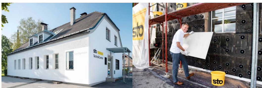
Energetische Sanierung des TechnikCenters am Standort Villach mit dem innovativen Klettsystem StoSustain R
