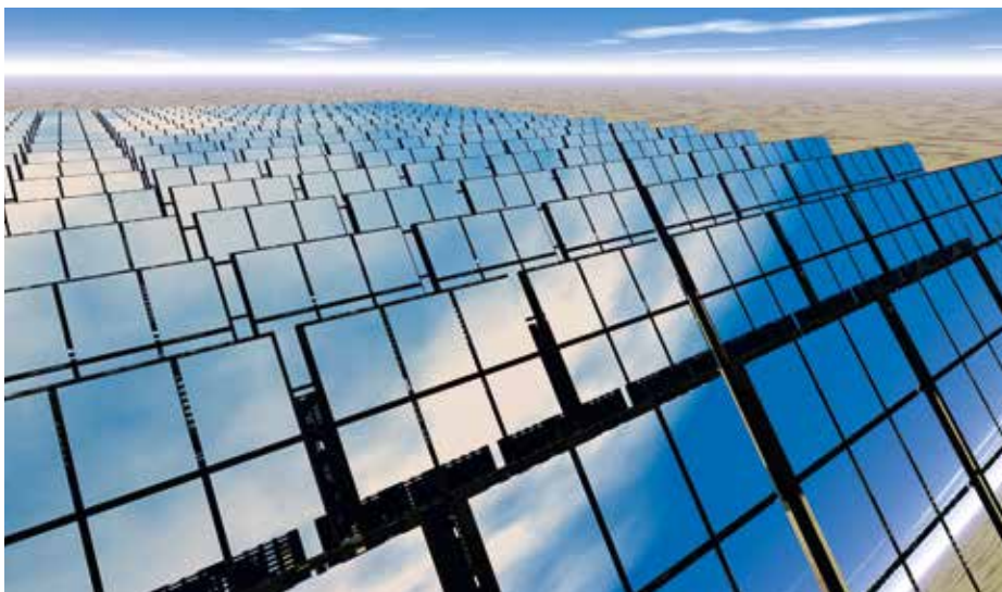
Großes Solarfeld mit Dünnschicht-Solarmodulen
