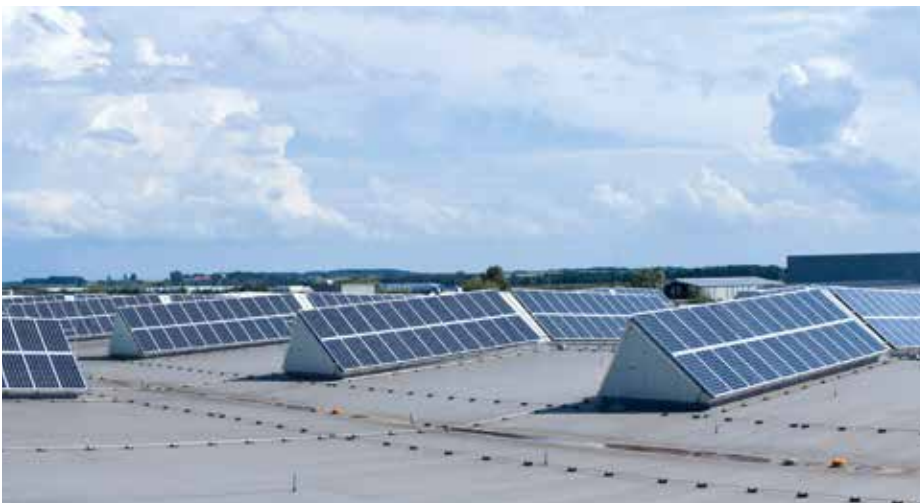
Solaranlage auf den Fertigungshallen von SINGULUS TECHNOLOGIES in Fürstenfeldbruck
