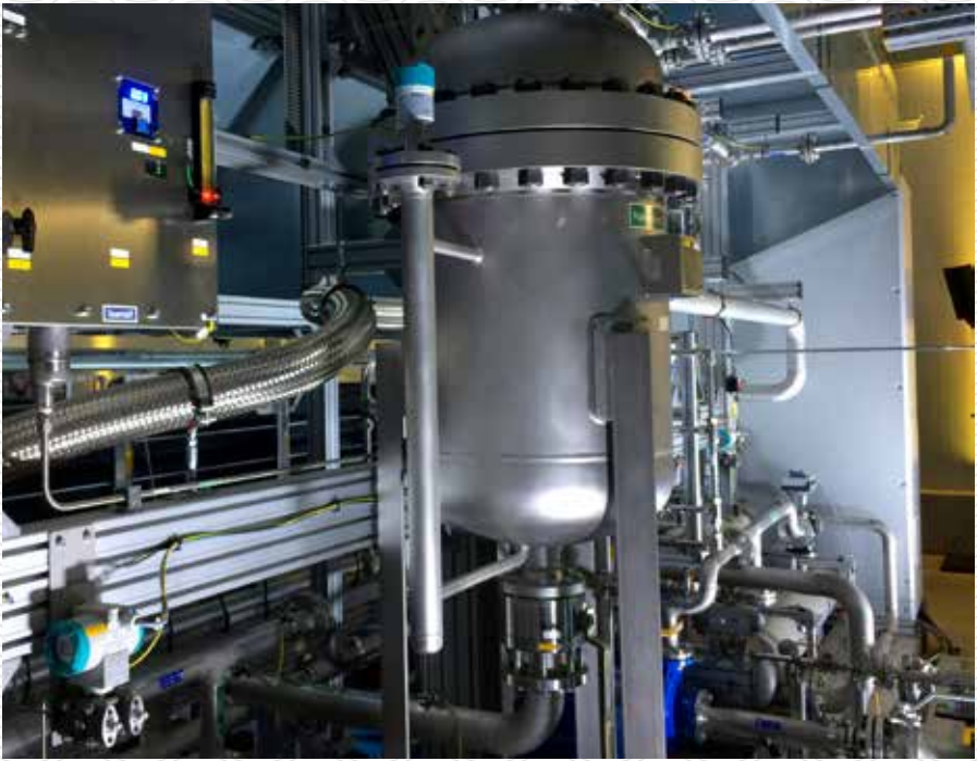
2017 in Betrieb genommen: die weltgrößte regelflexible Elektrolyse-Wasserstoff-Anlage in Hamburg
