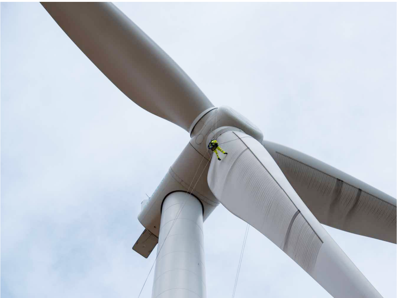
Inspektion von Rotorblättern einer Windkraftanlage
