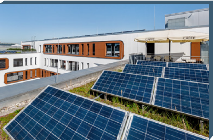
SOLARPANELS auf dem „NuOffice“ in München, Domagkstraße
